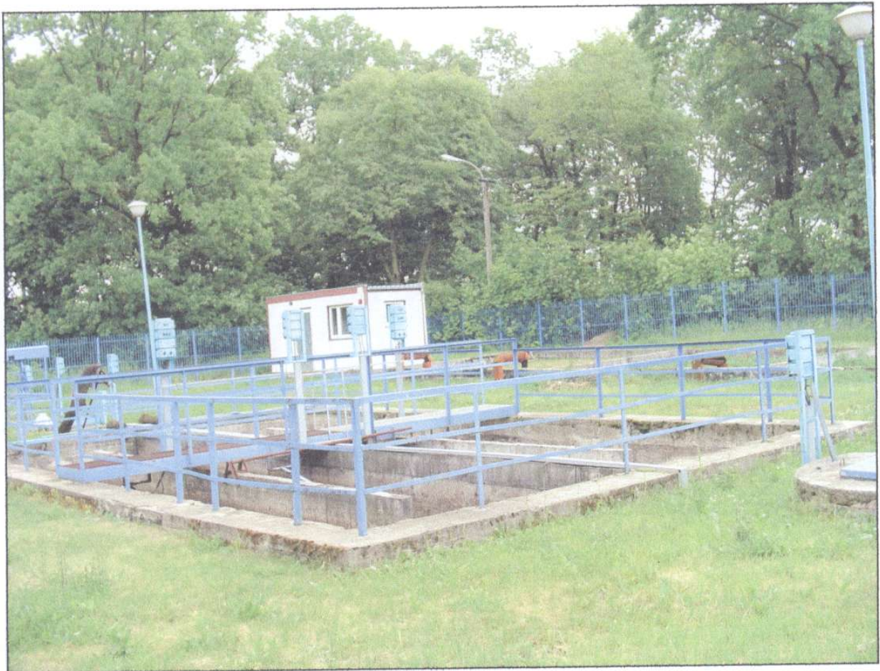
Oczyszczalnia ścieków w Smoszewie.
